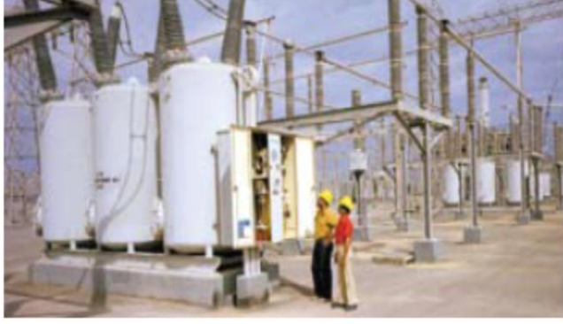
تطور قطاع الكهرباء في المنطقة الشرقية بشكل كبير
